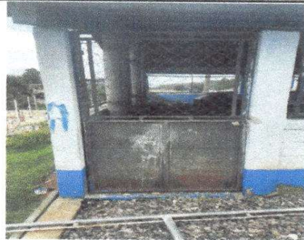
Foto 2: Mantenimiento de estructura: lijado y aplicación de pintura en puerta de metal del módulo 2 cocina
